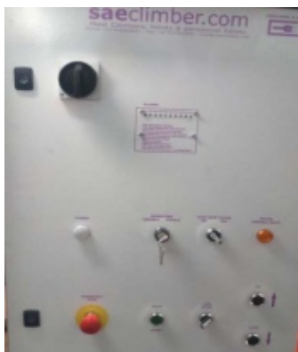
Alarmowe kontrolki diagnostyczne na tablicy
